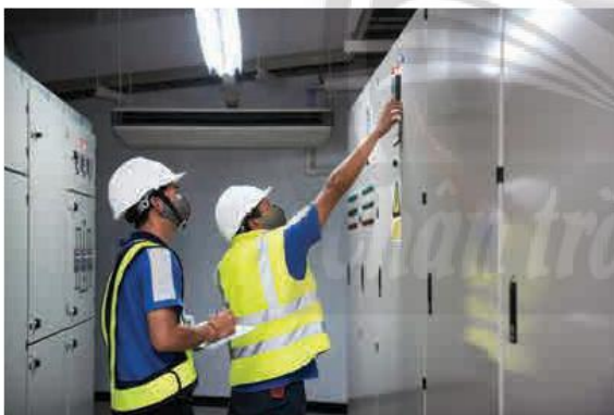
a) Vận hành hệ thống điện
