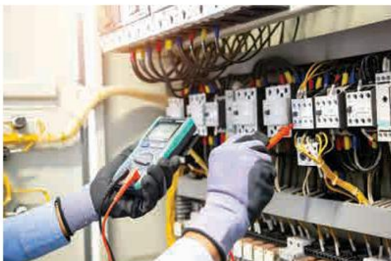
c) Bảo trì thiết bị điện
