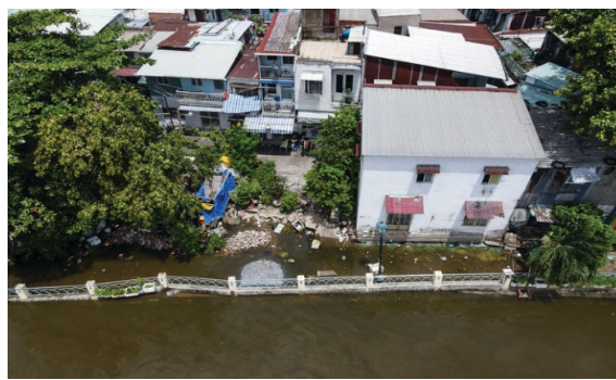
Hình 2. Đoạn kè kênh Thanh Đa, Phường 25, quận Bình Thạnh bị sạt lở hàng trăm mét và nhiều đoạn kè lều xiêu, nghiêng hẳn ra bờ sông (Nguồn: tuoitre.vn)
