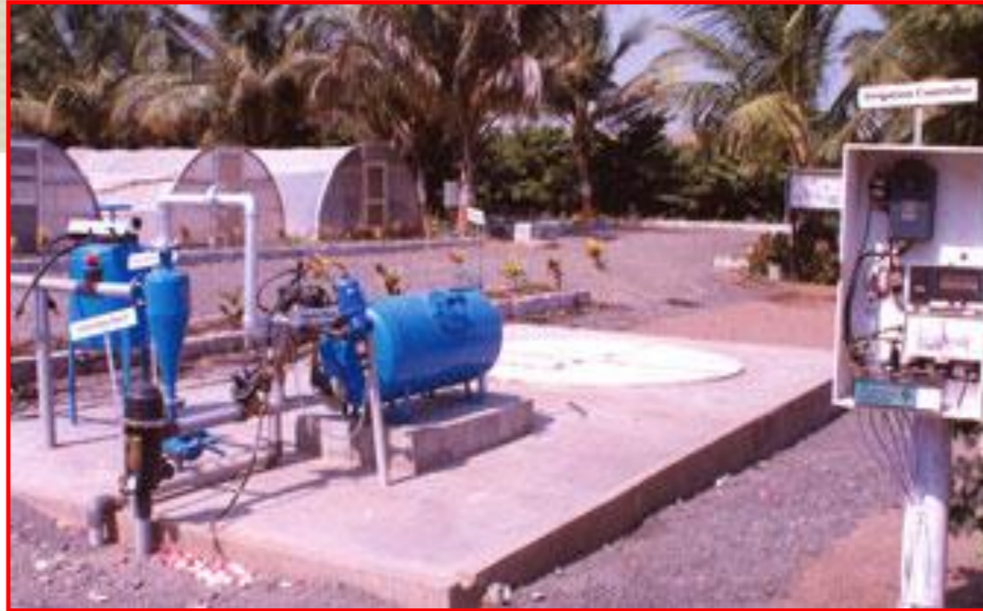
Trạm bơm nước
