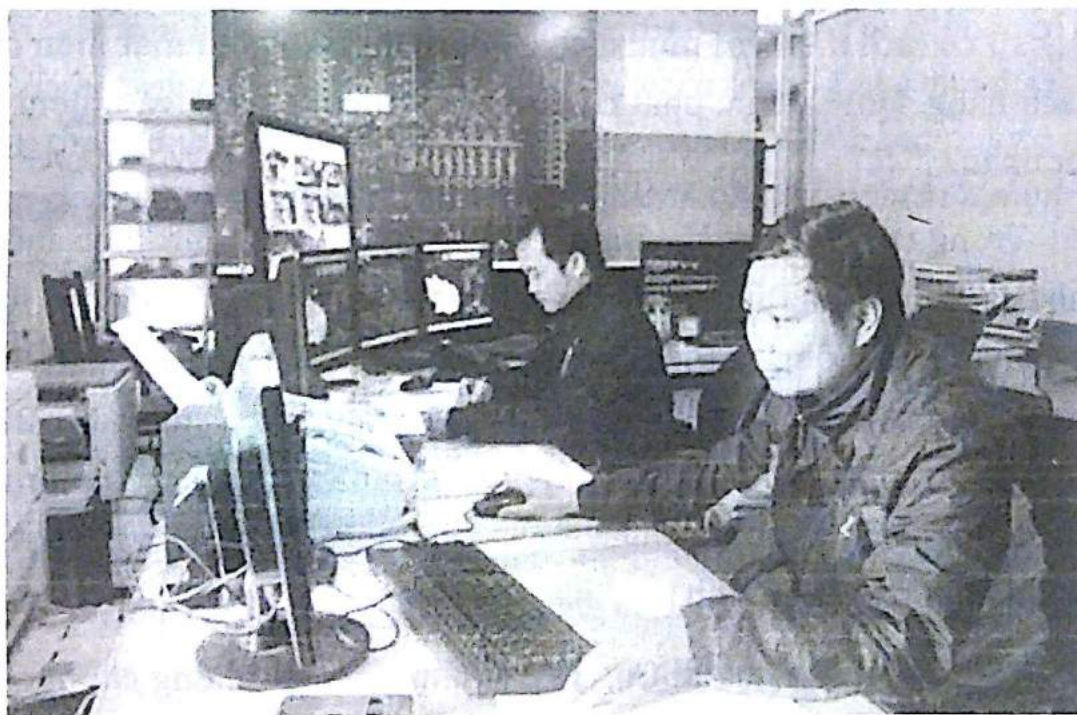
Phòng Điều độ Công ty Điện lực Bắc Ninh
