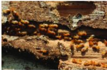
Mối phá hoại công trình xây dựng
